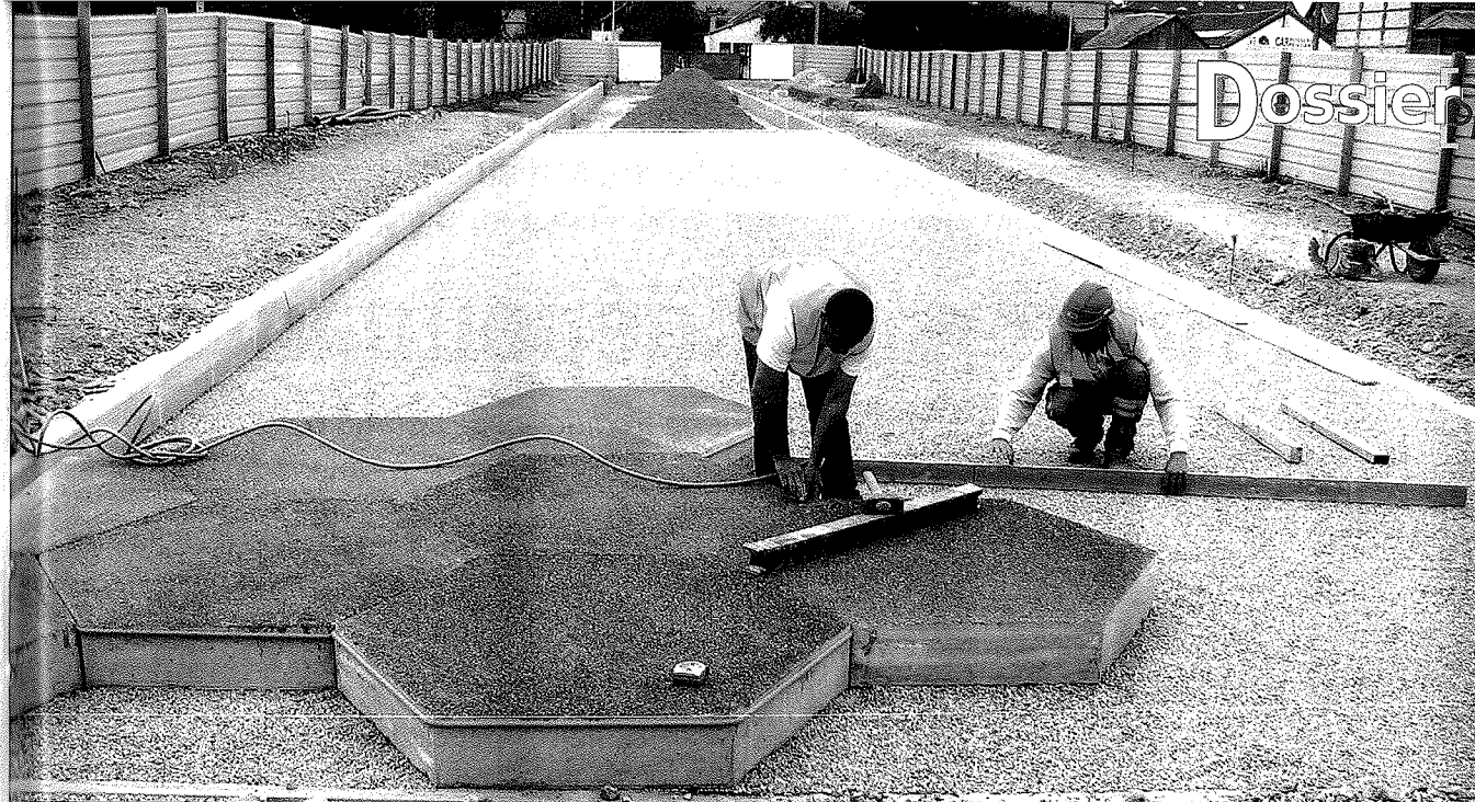
Réglage sur lit de pose et mise en place du joint élastomère entre les dalles déjà posées.
