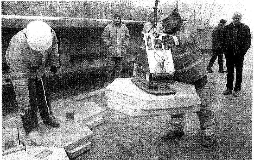
Fini, la poussière ou le marteau-piqueur pendant des semaines ! Avec la chaussée démontable, en une demi-journée, la route est ouverte et refermée pour effectuer des travaux.
